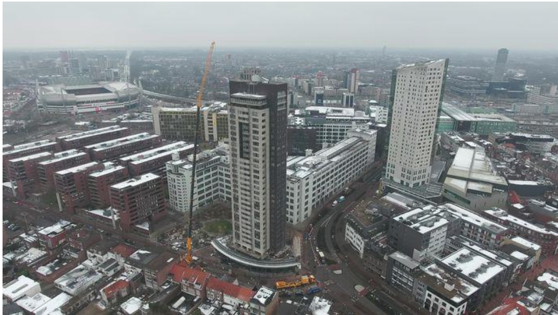
Woontoren De Regent in Eindhoven wordt in de steigers gezet voor vervanging van de scheurende en afbrokkelende gevels. De monsterklus voor sloopbedrijf M. Heezen en bouwbedrijf BanBouw gaat naar schatting anderhalf jaar duren. © ED
